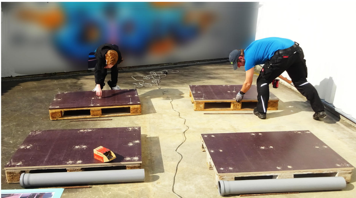
Abb. 11: Teamwork: Jan Rust und Sven Petry arbeiten Hand in Hand bei der Montage der Stützenfundamente. Am Bautag im Fördertechnikmuseum sind viele Arbeiten gleichzeitig zu erledigen. Alle Teams legen ein unglaubliches Arbeitstempo vor, sodass die Seilbahn jetzt sichtbare Formen annimmt. Am Abend sind alle fertig – die Fundamente und auch die Helfer.
